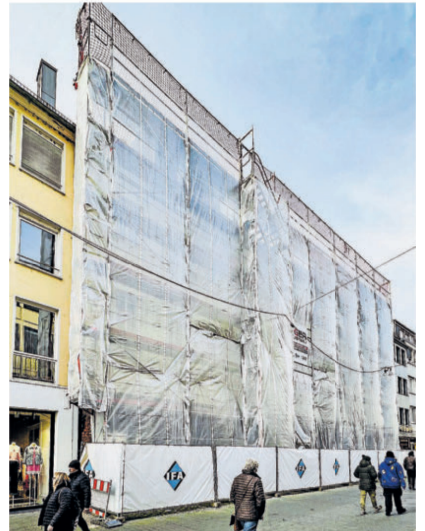
Noch sind die Handwerker fleißig am Werk, denn das ehemalige Lürenbaum-Haus wird derzeit aufwändig saniert, um die Brotstraße zu beleben.
